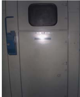
Figura No. 2.3 Armario de un Transformador.
