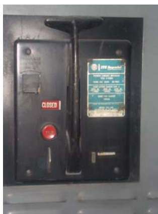
Figura No. 2.1 Equipo de Interrupción (Switchgear).
