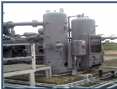
Figura 9. Depuradores Interetapas de compresión.
