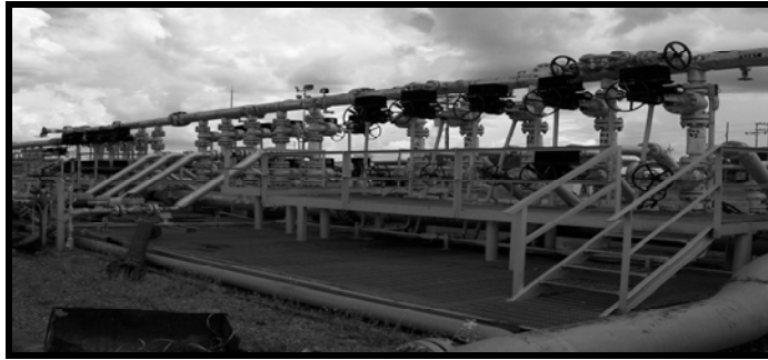
Figura 2.3 Múltiple de Producción. [Fuente: Campo Furrial (Este)]
