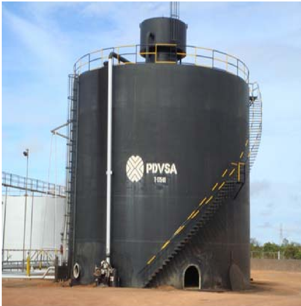
Figura 4.6. Tanque de lavado de la estación de descarga GED-14.
