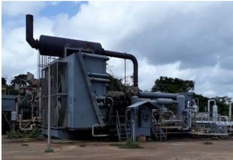
Anexo B.16 Motocompresor K-3 de la Planta Compresora Zapatos
