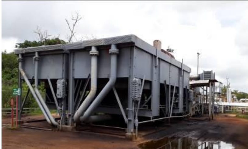
Anexo B.15 Motocompresor K-1 de la Planta Compresora Zapatos
