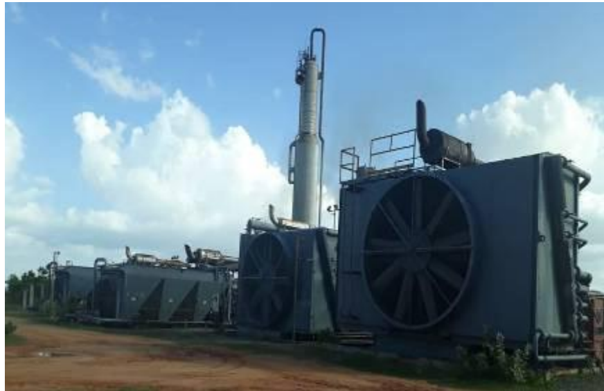
Anexo B.18 Motocompresores Fase II de la Planta Compresora Mata R.
