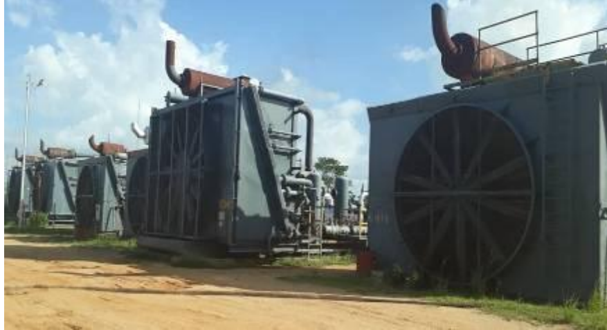
Anexo B.17 Motocompresores Fase I de la Planta Compresora Mata R.
