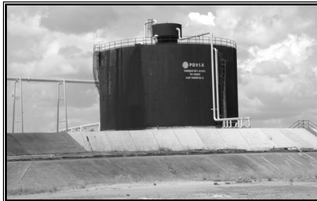
Figura 2.16. Tanque de Lavado
