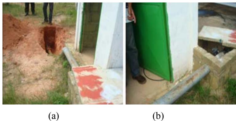
Figura 3.21. Afueras de la Caseta de Cloración. (a) Tubería Hacia la Red de Distribución, (b) Sistema de Aplicación de Cloro.
