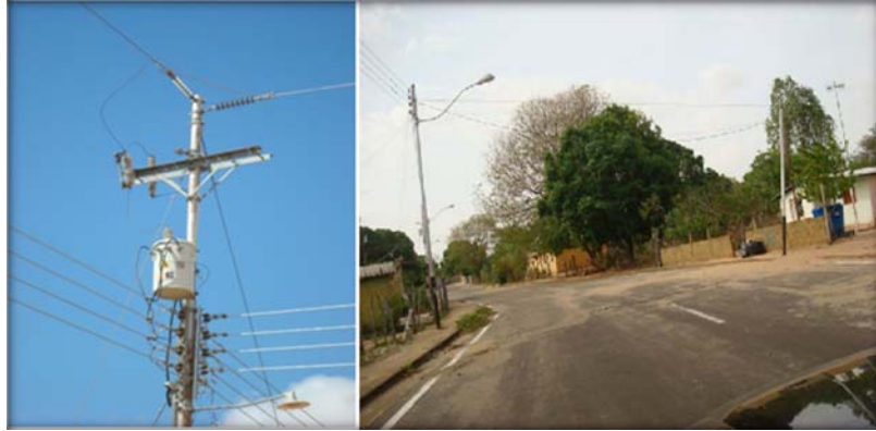
Figura 1.7. Servicio de Electricidad
