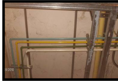
Figura 4.6. Tuberías de gases medicinales
