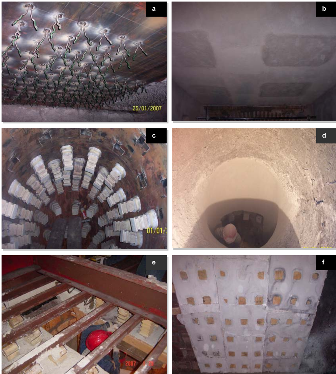
Figura 3.12. Ejemplos del antes y después de revestimiento refractario: a) Distribución de anclas metálicas soldadas en sección de bóveda de pellas, b) revestimiento de la sección de bóveda por proyección; c) bajante del ducto a la cámara de combustión en pellas con anclajes cerámicos; d) bajante revestido por proyección; e) distribución de anclajes cerámicos en sección de bóveda en la zona de quema en pellas; f) vaciado de la sección de bóveda en la zona de quema.
