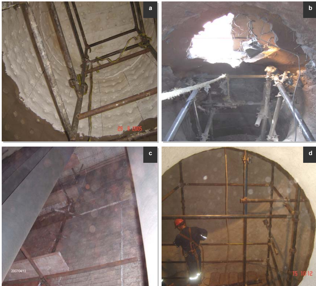
Figura 3.16. Ejemplos de andamios: a) andamio construido en el interior de un horno de recocidos, b) andamio construido en el ducto de gas en Midrex I, c) andamio en el interior del reformador de Midrex I, d) andamio en el ducto de gases del reactor 6 de HyL .
