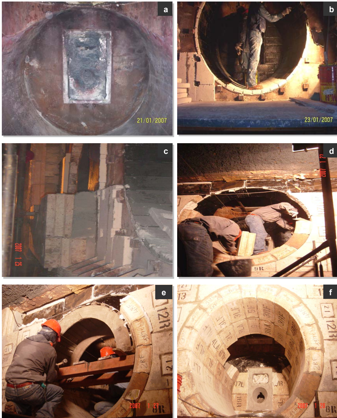
Figura 3.17. Ejemplos de fases construcción de una cámara de combustión: a) Cámara totalmente demolida y en centro quemador dañado, b) colocación de placas de fibra cerámica a la carcasa metálica del equipo, c) detalle del espesor de concreto entre la placa y la pieza premoldeada, d) instalación de piezas en el anillo, e) encofrado de madera que sirve de apoyo al cierre del anillo, f) cámara totalmente construida.
