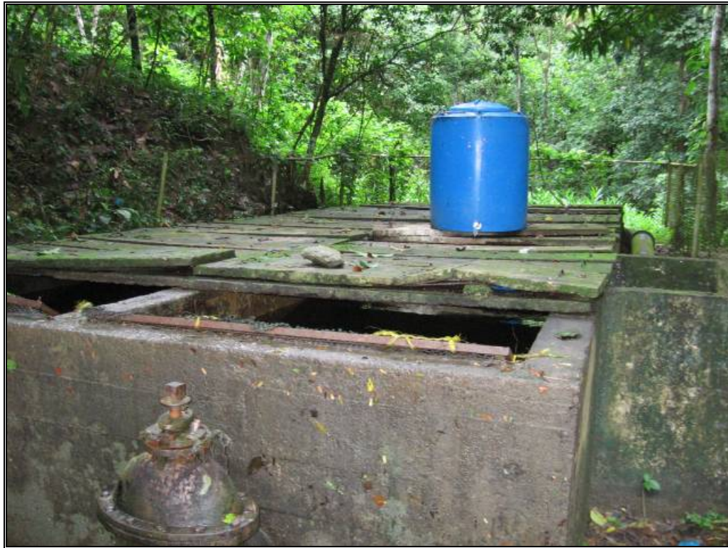
Figura 3. 1 Desarenador. (Obsérvese el sistema de pre-cloración por goteo)
