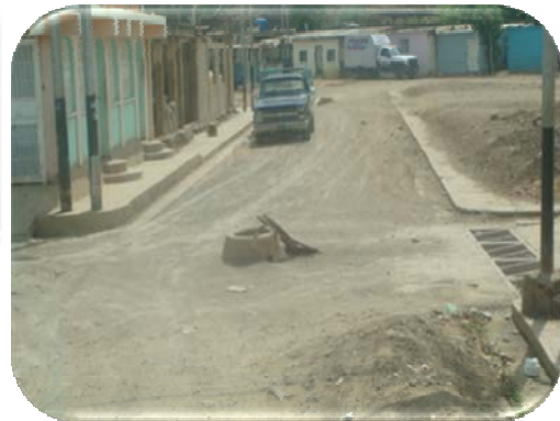
Figura 4.5.2 Boca de Visita que Sobre
