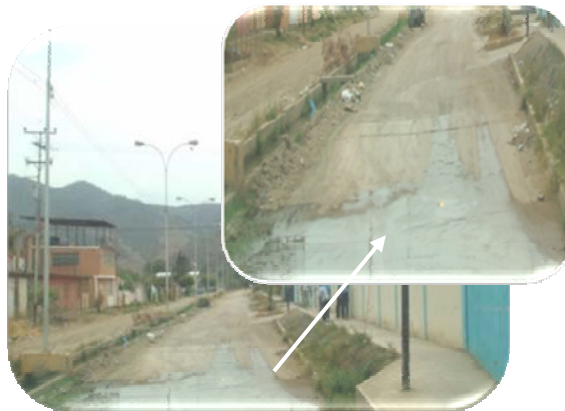
Figura 4.5.1 Calles en Mal Estado.
