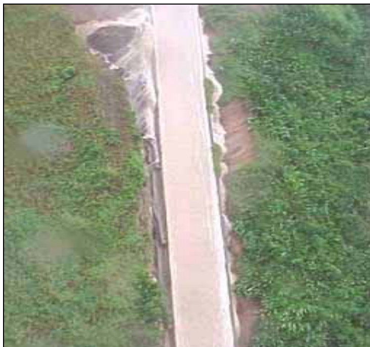
Figura N° 2.18. Incremento del rebose del canal, ya se observa la erosión del talud de la presa
