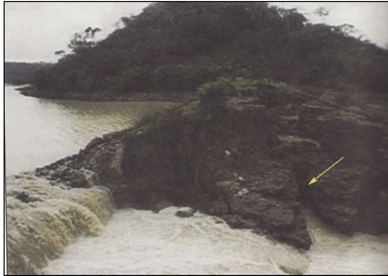
Figura N° 2.14. Presa el Cristo detalle de la erosión.
