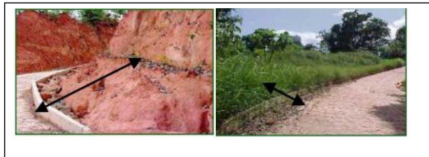
Figura 5.19 Tecnología sistema vetiver interfaz suelo- concreto.
