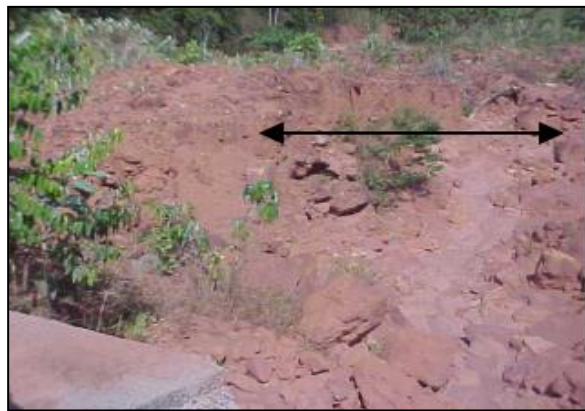
Figura 5.15 Socavación Lateral. Caño El Chorro.
