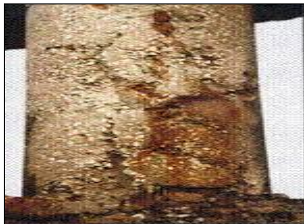
Figura 3.13 Daños por agua en cimentación (Azkárate, I., et al., 2005).
