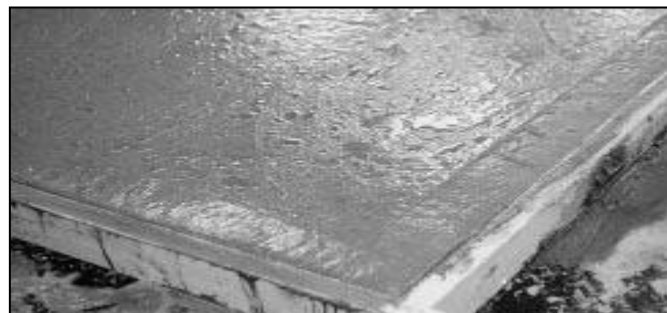
Figura 3.8 Agua de exudación en la superficie del concreto de una losa. (Kosmatka, S. et al. , 2004).
