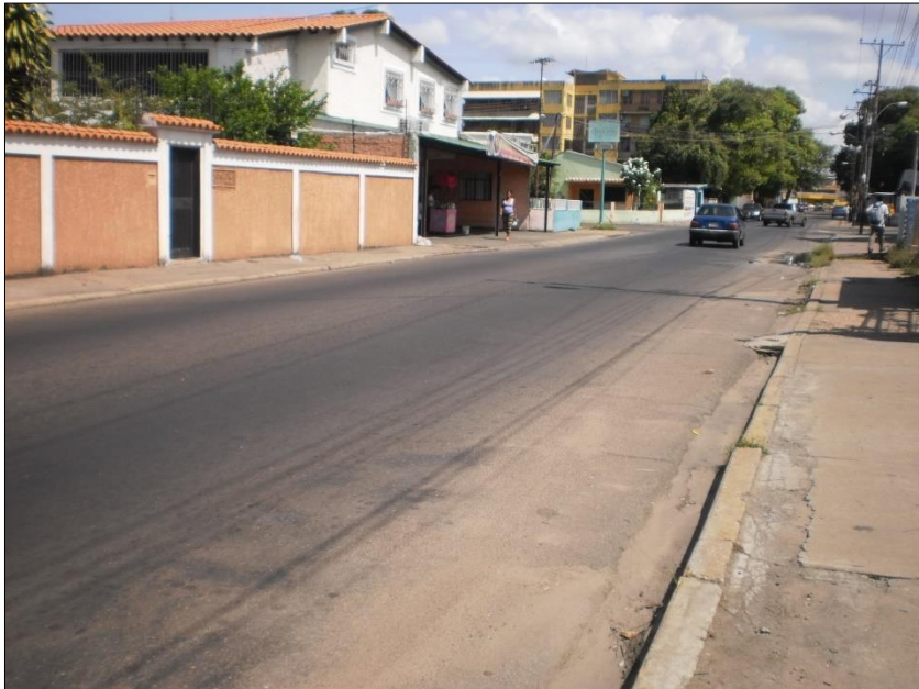
Figura 1 Condiciones de la vía Sentido Este.
