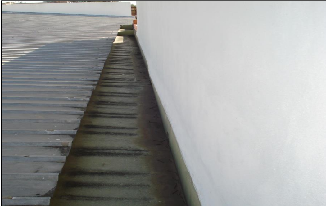
Figura 5.2 Características del canal de recolección de agua de lluvia del galpón.
