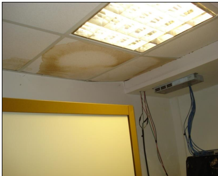
A. 7. Efectos del mal funcionamiento del sistema de drenaje de techo del galpón del Supermercado El Diamante.
