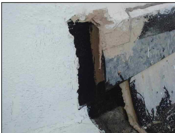
A.8. Incorrecta instalación del canal de recolección de agua de lluvia del galpón del Supermercado El Diamante.
