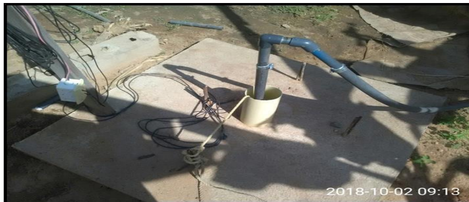
Figura 2.2 Vista del área donde se perforó el pozo artesiano, actualmente en producción.
