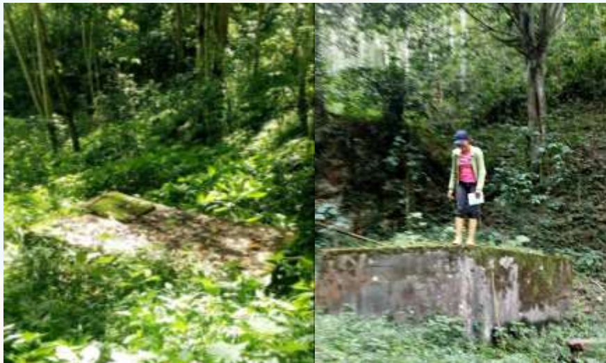
Figura 9. Tanques de suministro de agua ubicados en la hacienda “Las Acacias”
