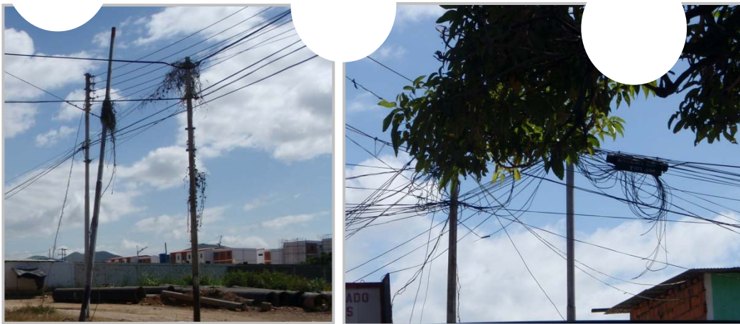
Imagen IV.49. Irregularidades del Tendido Eléctrico en la zona.
