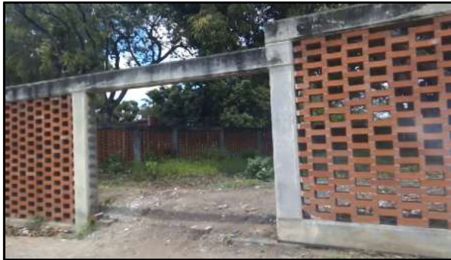
Figura 5.1 Paño # 103 a, faltante en su totalidad
