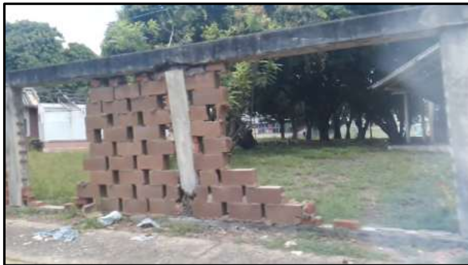
Figura 5.2 Paños # 85 a y # 86 a, columnas y vigas colapsadas
