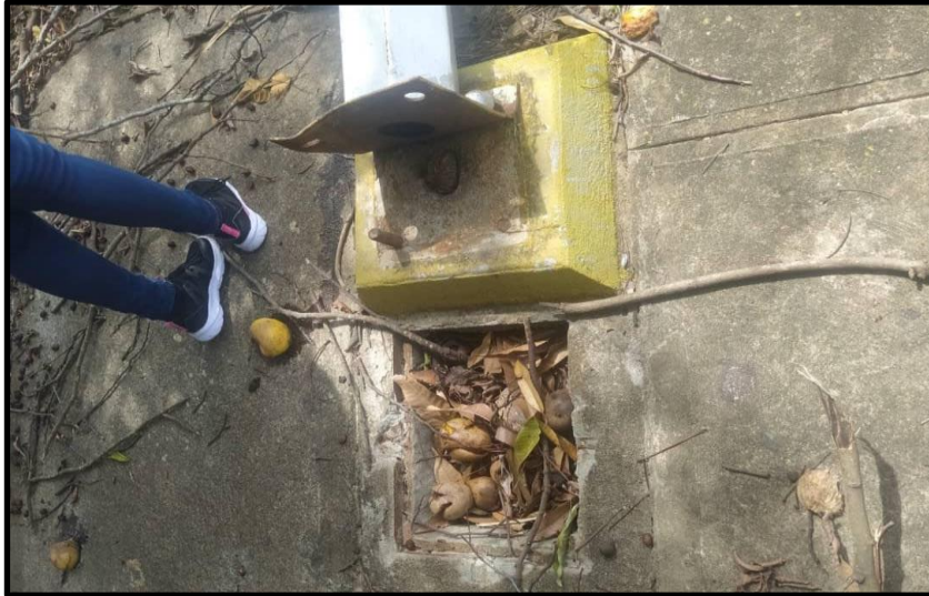
Figura 5.4. Bases de Postes para Alumbrado Público en los alrededores del Comedor de la Escuela de Ciencias de la Tierra.
