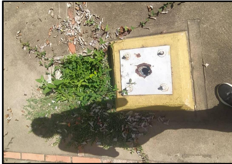
Figura 5.2. Bases de Postes para Alumbrado Público en los alrededores de la Antigua Biblioteca de Ciencias de la Tierra.
