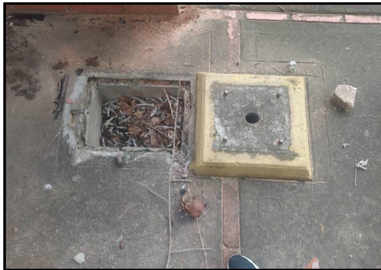
Figura 5.3. Bases de Postes para Alumbrado Público en los alrededores del Miniauditorio de la Escuela de Ciencias de la Tierra.
