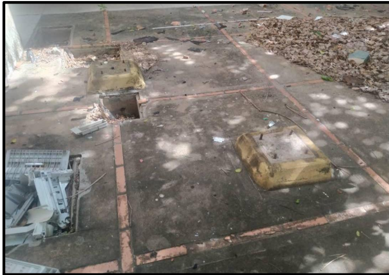
Figura 5.1. Bases de Postes para Alumbrado Público en los alrededores del Edificio Principal de Ciencias de la Tierra.
