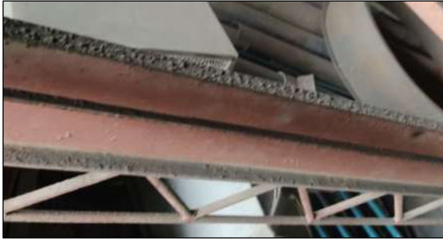
Figura 5.16 Fotografía de elementos estructurales corroidos del galpón.
