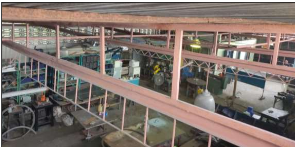
Figura 5.13 Fotografía de elementos estructurales corroidos del galpón.
