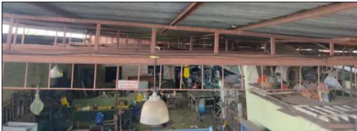
Figura 5.12 Fotografía de elementos estructurales corroidos del galpón.
