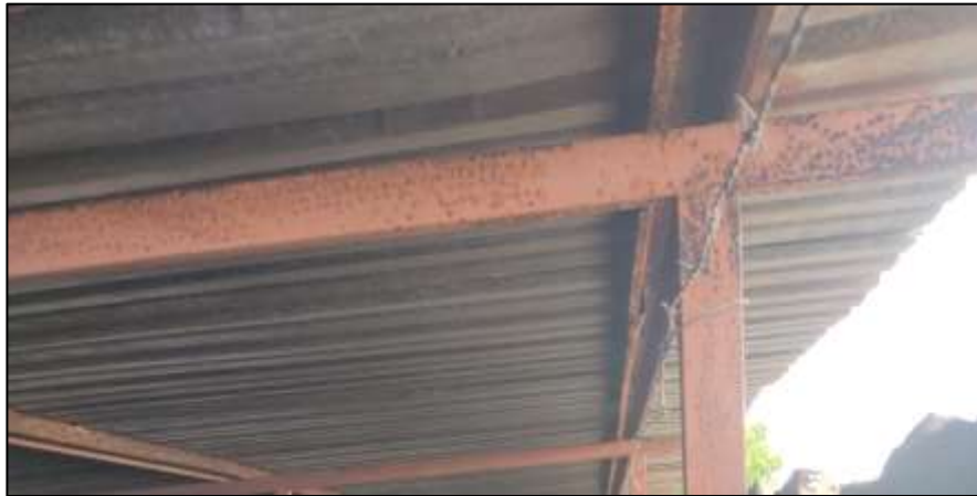
Figura 5.14 Fotografía de elementos estructurales corroidos del galpón.
