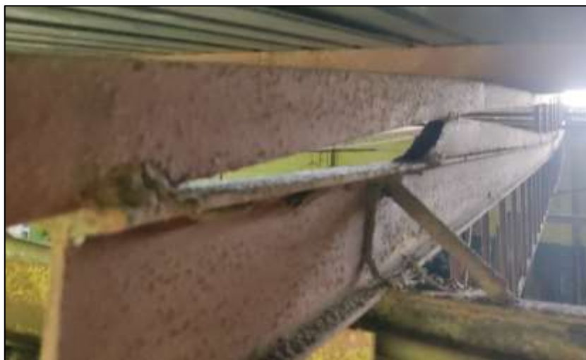
Figura 5.11 Fotografía de elementos estructurales corroidos del galpón.
