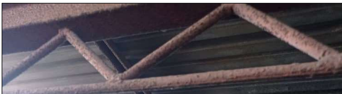
Figura 5.10 Fotografía de elementos estructurales corroidos del galpón.
