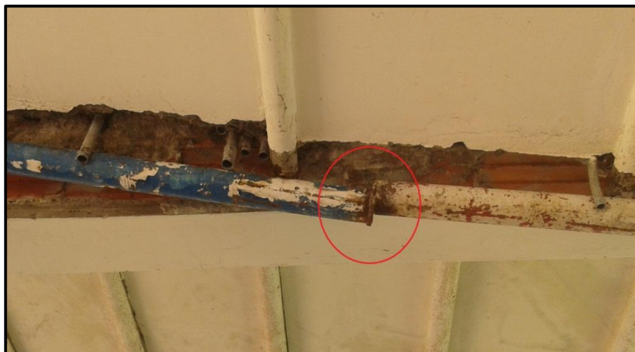
Figura 30. Tramo de viga no alineado y unido por un punto de soldadura. Fuente: Autor
