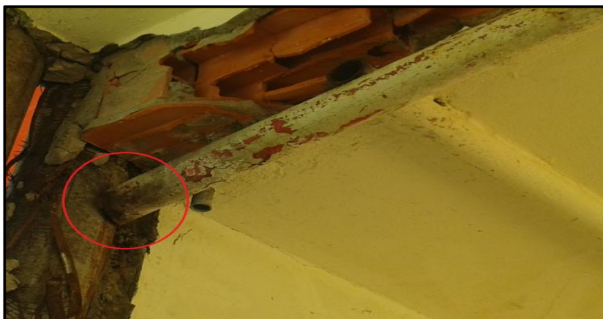
Figura 31. Unión de viga con columna con un punto de soldadura. Fuente: Autor
