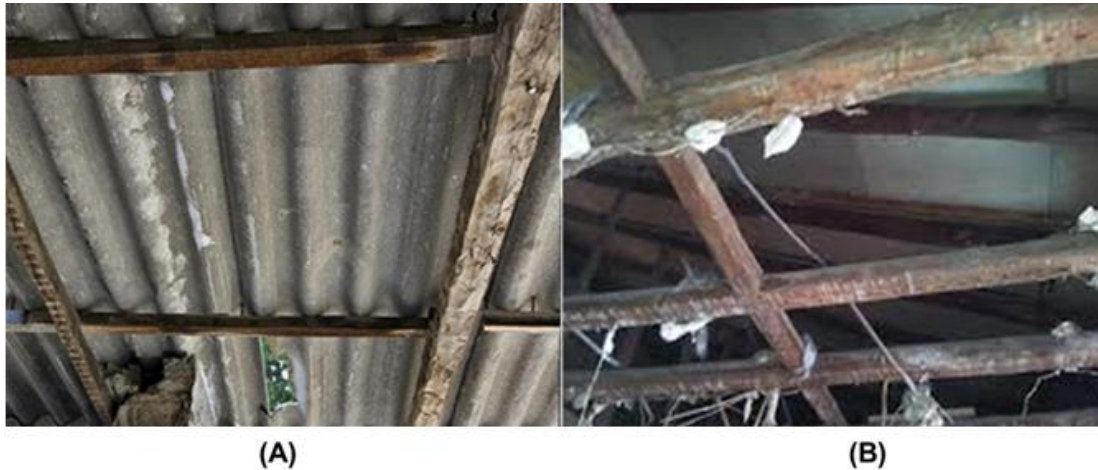
Figura 5. Patologías en Edificio de Desarrollo Urbano EN7. A) Condición de deterioro de estructura de madera y cubiertas de asbesto. B) Condición de deterioro en armadura metálica. Fuente: Autor.
