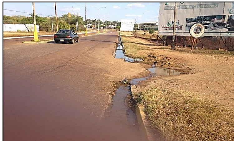
Figura 38. Interrupción de la escorrentía en la cuneta por construcción de rampas de acceso, en la prolongación de la Avenida Bolívar.
