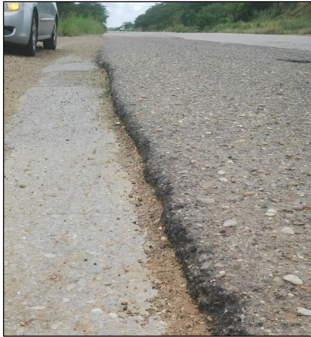
Figura 16 Rotura de borde, km 11. Fuente propia. 2017
