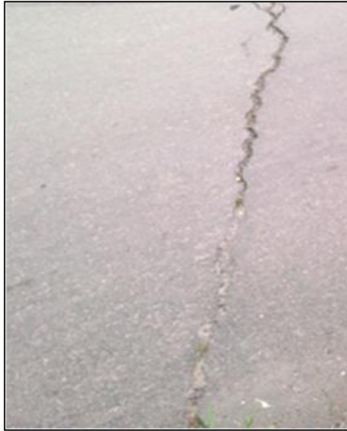
Figura 14 Estría Longitudinal, Km 14 Fuente propia. 2017
