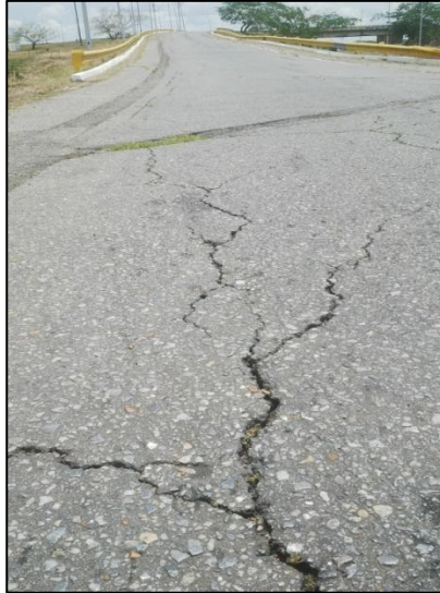
Figura 8 Fisura longitudinal, km 0.10. Fuente propia. 2017
