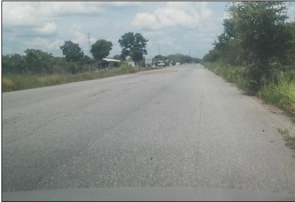
Figura 7. Hinchamiento, km 7.4. Fuente propia. 2017
