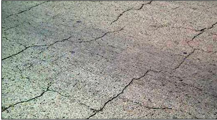
Figura 10 Fisura de bloques, km 13. Fuente propia. 2017
