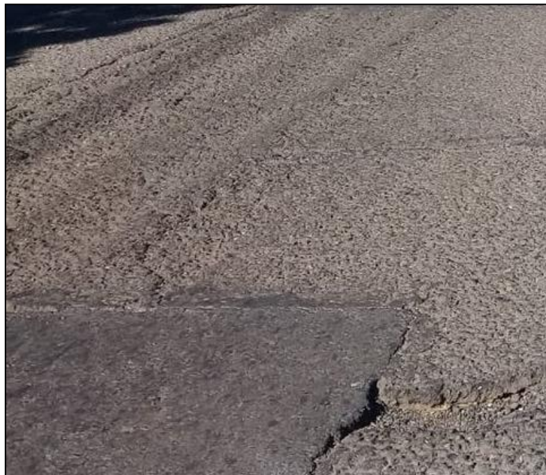
Figura 17 Bacheo, km 8. Fuente propia. 2017
