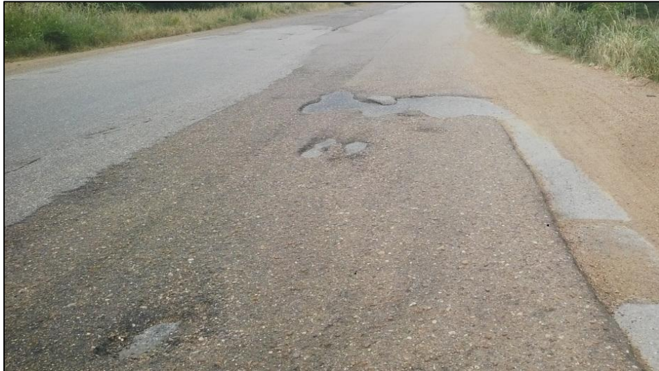
Figura 12 Descubrimiento de agregados, km 10.8 Fuente propia. 2017
