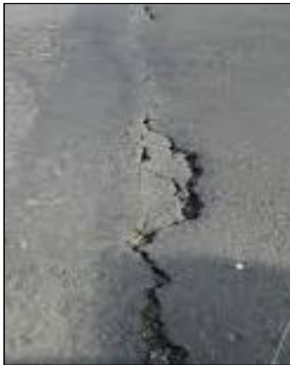
Figura 9 Fisura Transversal, km 12. Fuente propia. 2017
