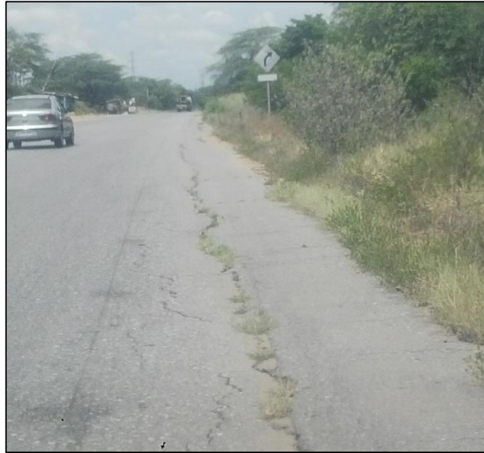
Figura 5 Ahuellamiento, km 0,80. Fuente propia. 2017
