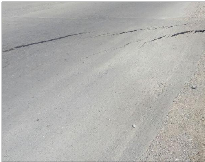
Figura 6. Hundimiento, km 10.8. Fuente propia. 2017
