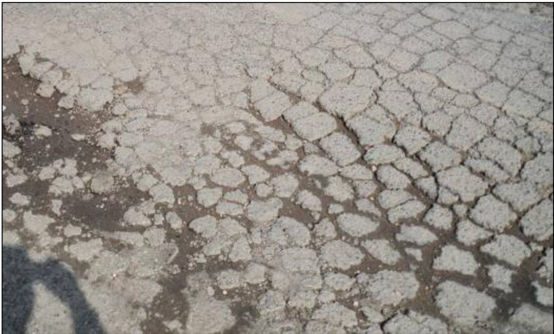
Figura 11 Fisura tipo piel de cocodrilo, km 9,2. Fuente propia. 2017
