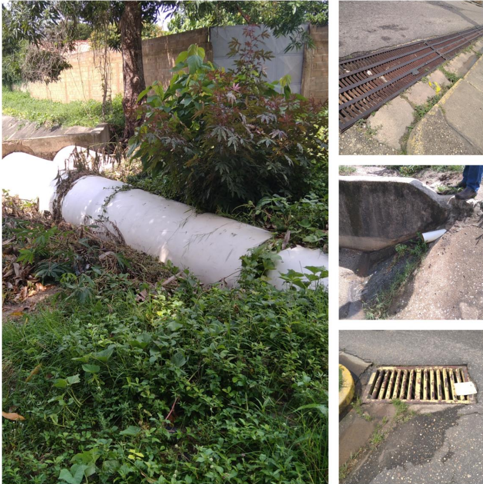
Ilustración 23. Condiciones del drenaje pluvial. Fuente: Autores (2022)
