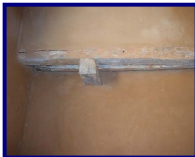
Gráfico 29: Viga en mal estado.
