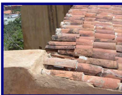
Gráfico 30: Techo en mal estado.
