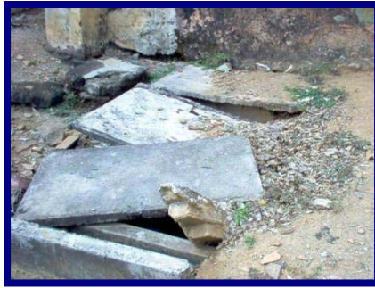
Gráfico 28: Desagüe en mal estado.
