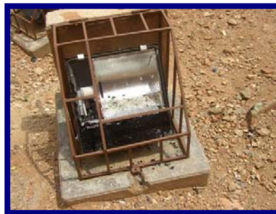
Gráfico 33: Reflectores de iluminación en mal estado.
