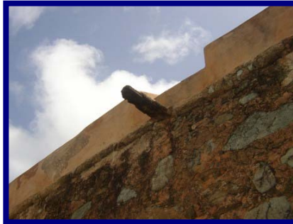
Gráfico 45: Viga de madera en mal estado.
