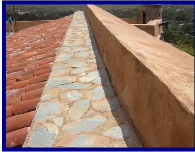
Gráfico 31: Grietas en la caminería del lado derecho.
