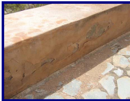
Gráfico 25: Paredes sucia, agrietadas y la pintura se desmorona.
