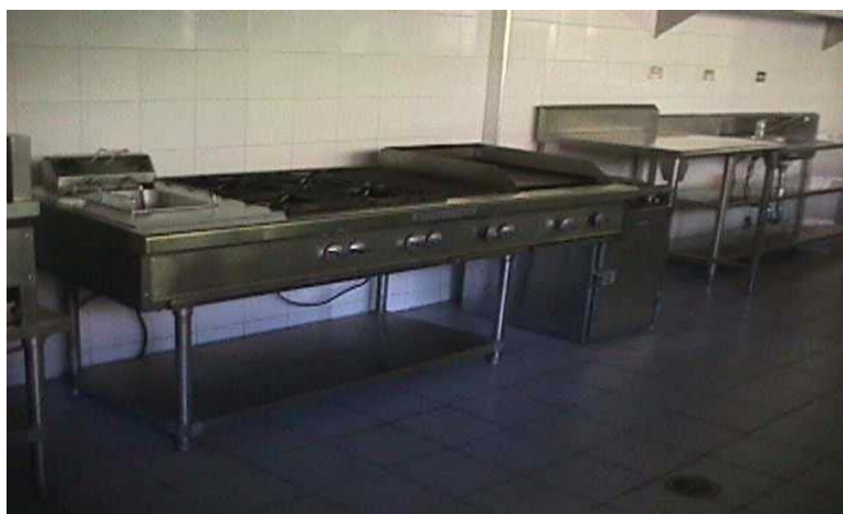
FIGURA 21. EQUIPOS –MESA DE TRABAJO, PLANCHA Y FREGAPLATO DE TRABAJO.
