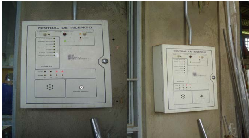
Figura 4.2. Central de incendio
