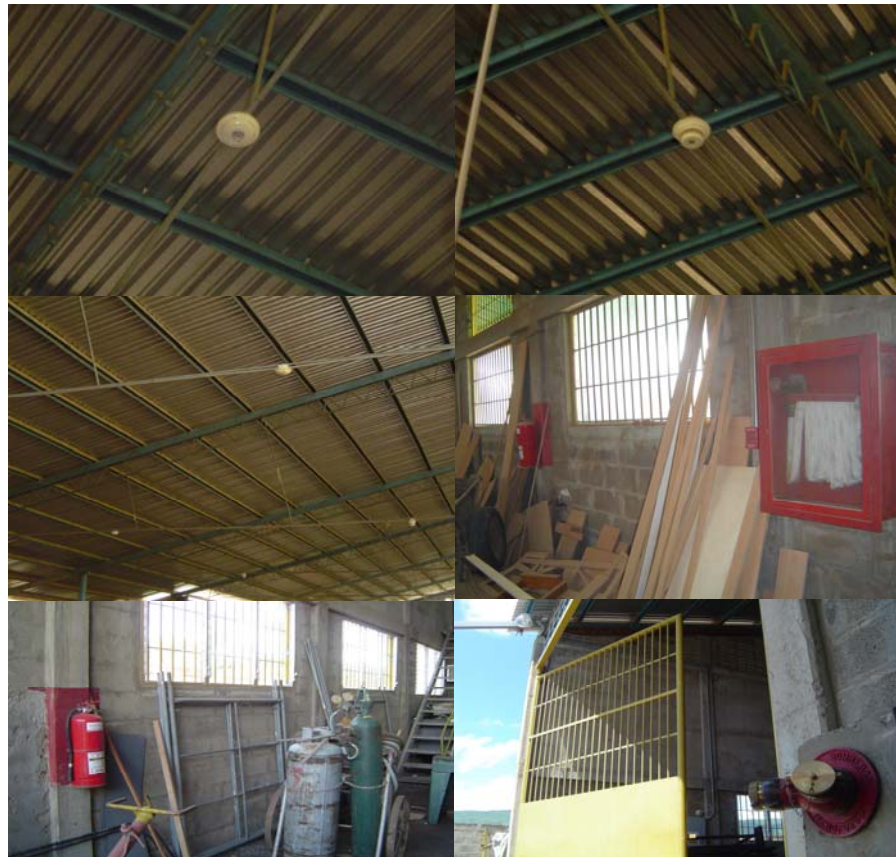
Figura 4.3. Sistema de protección contra incendios
