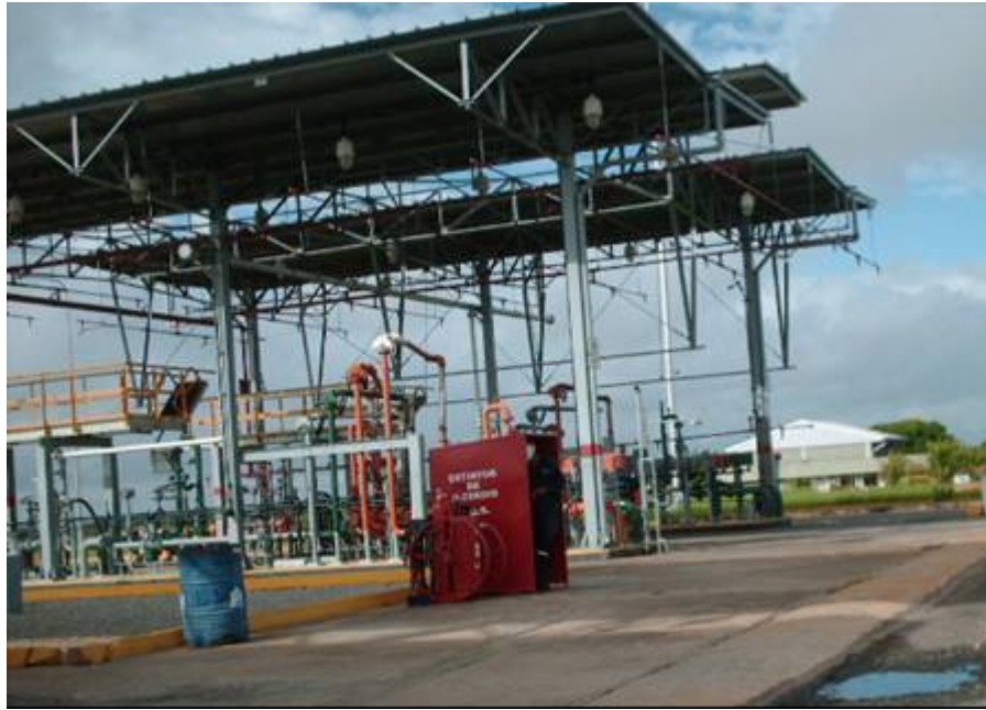
Figura B.1. Operario utilizando el celular en el área del llenadero
