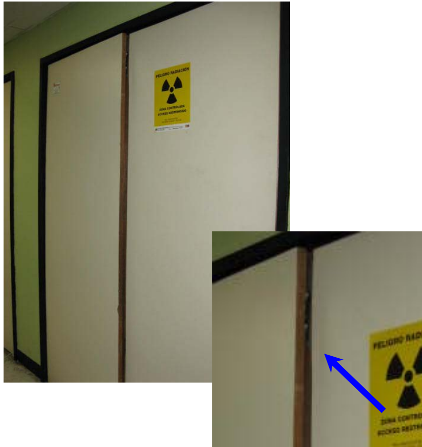
Figura 4.15. Imagen de la condición de las puertas que dan acceso al área de toma de radiografías
