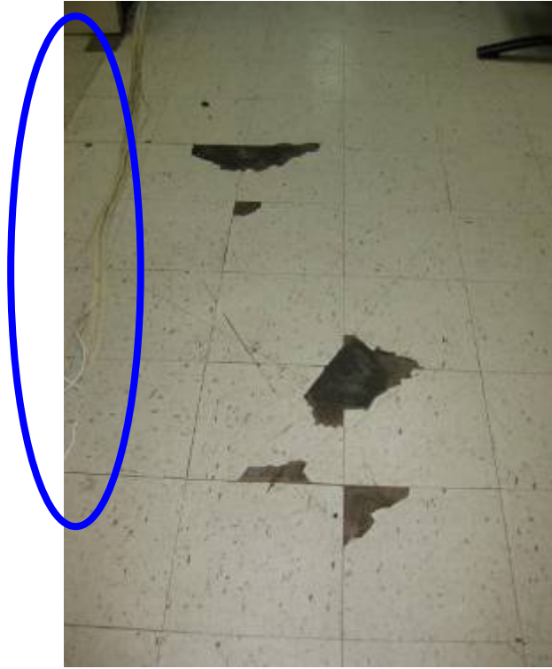
Figura 4.14. Cables sujetos con tirro
