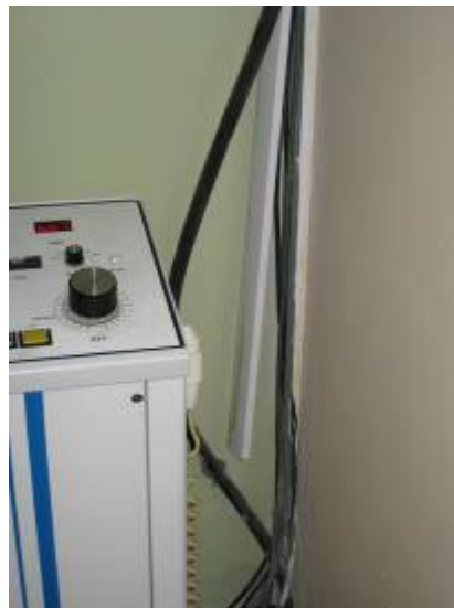
Figura 4.17. Cables fuera de la canaleta.
