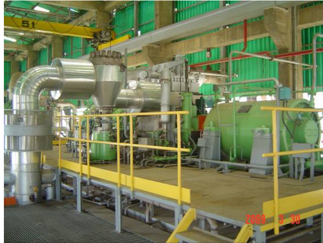
Figura 2.8. Compresor de gas de síntesis (K-301)
