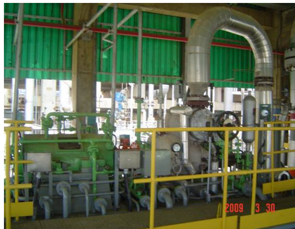
Figura 2.2. Vista Este del Turbo compresor (K-101) Fuente: El autor
