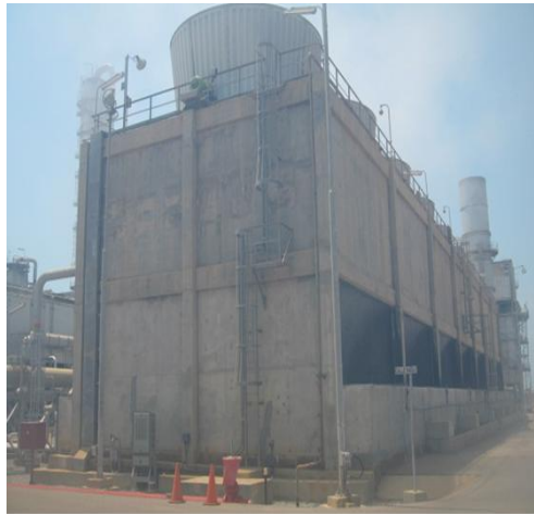
Figura 2.10. Torre de enfriamiento (T-611) Fuente: El autor
