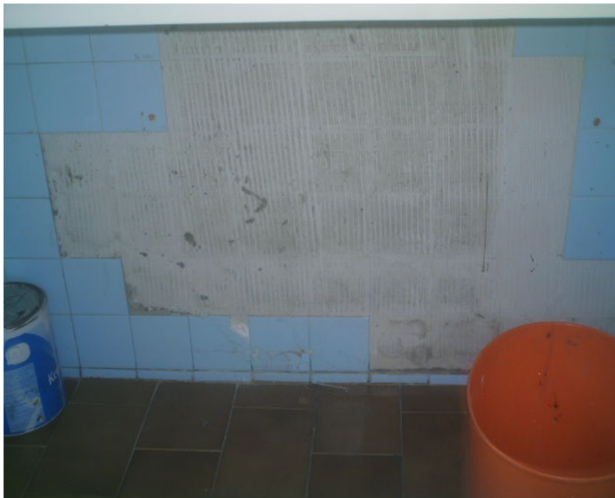
Infraestructura en condiciones desfavorables.
