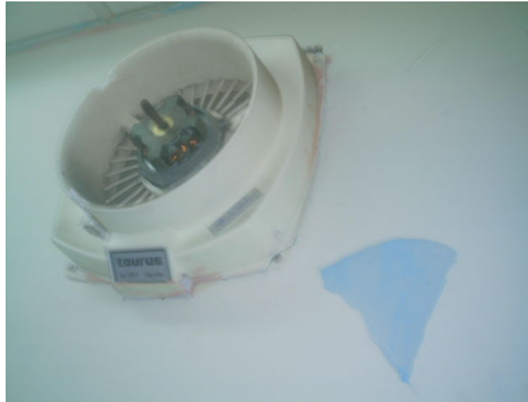
Falta de ventilación.
