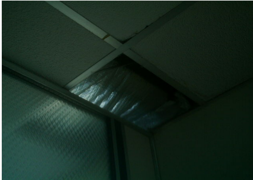
Área de oficina techo en mal estado.
