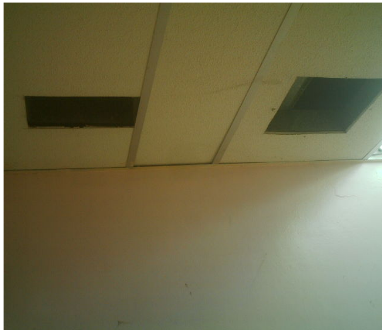
Cuarto de los auxiliares: ventilación deficiente.
