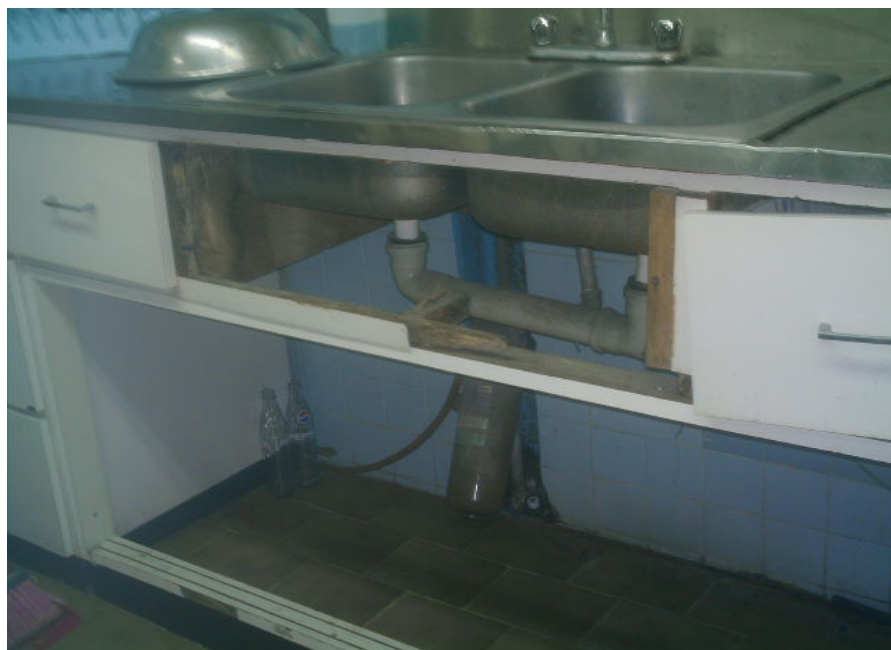
Área del lavado de material: fregadero en malas condiciones y acumulación de basura.
