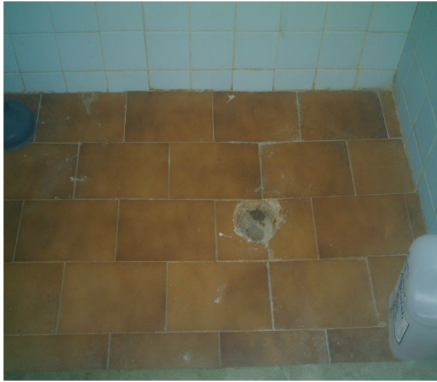
Sanitarios en malas condiciones.
