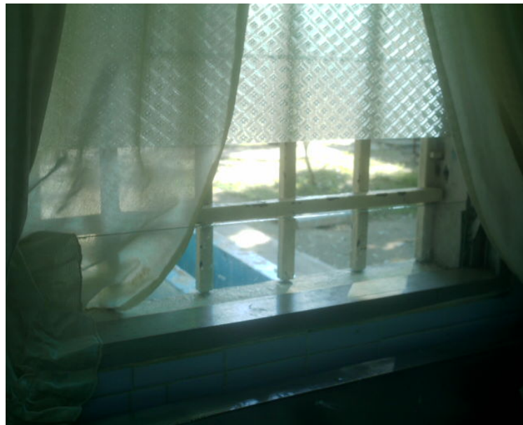
Falta de vidrios en ventanas.
