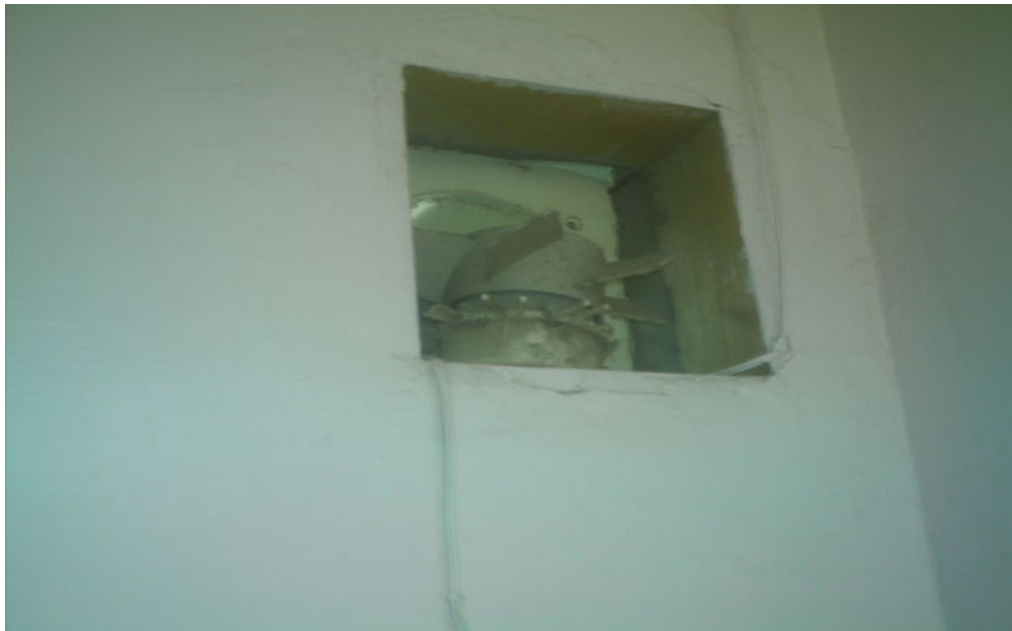
Figura 4.10. Cuarto de auxiliares.
