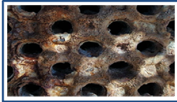
Figura 7. Intercambiador de calor que presenta problemas de depósitos.
