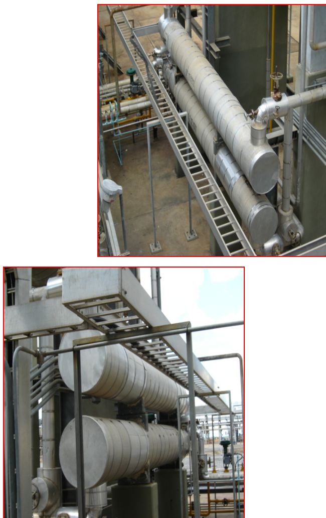
Figura 4.4 Diferentes vistas de los intercambiadores laterales utilizados en la regeneración del Glicol.
