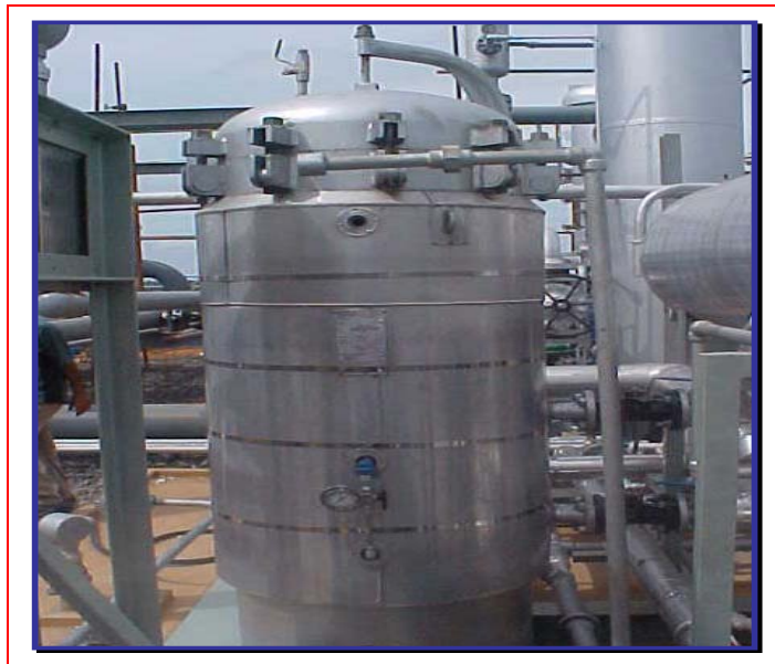
Figura 4.9 Vista frontal del Filtro de Carbón Activado.
