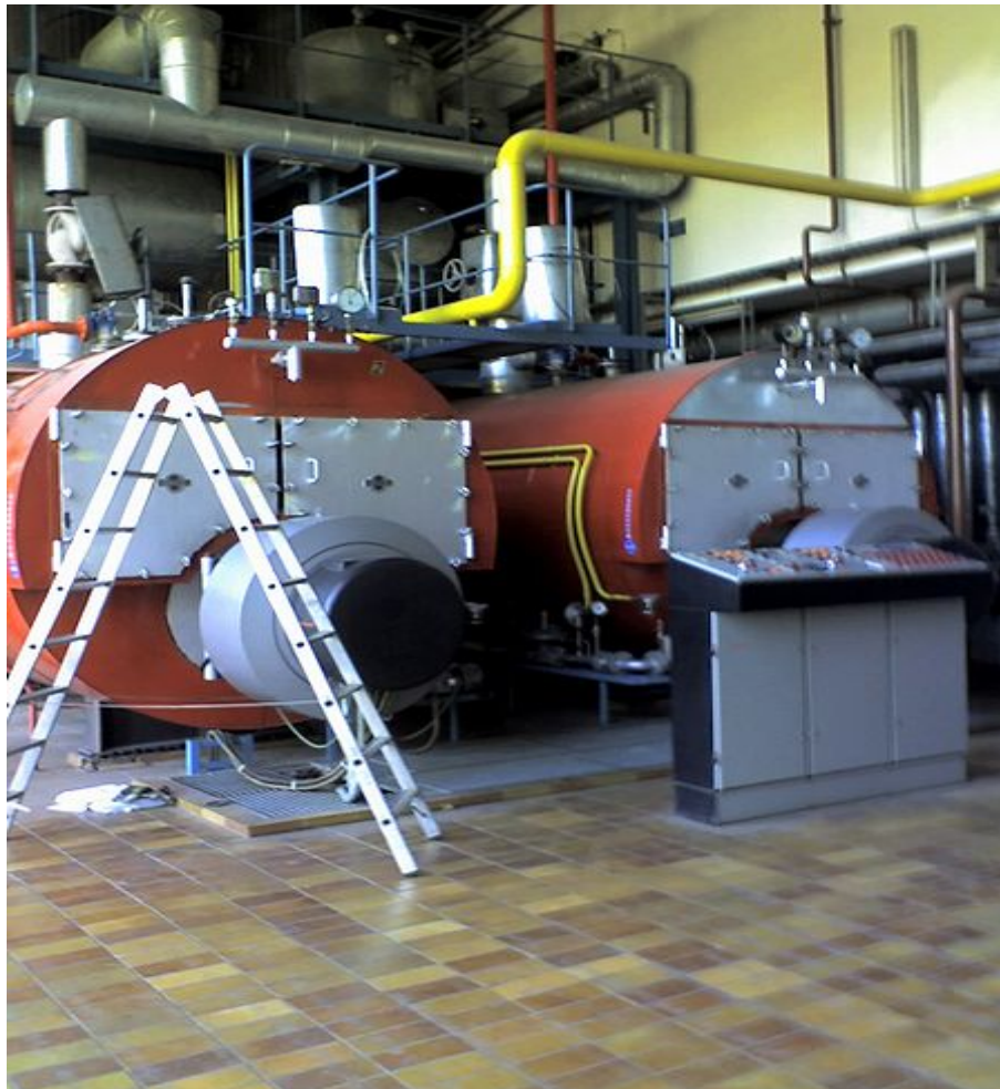
Figura 2.1. Caldera de vapor.
