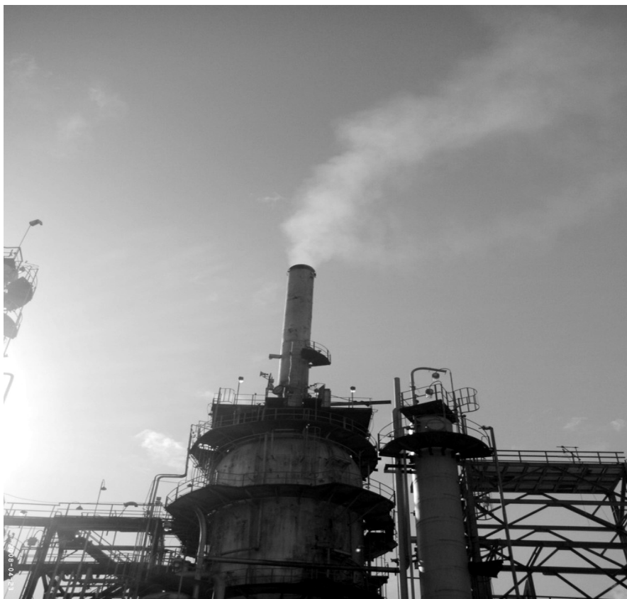
FIGURA 4.6. Chimenea del convertidor de FCC
