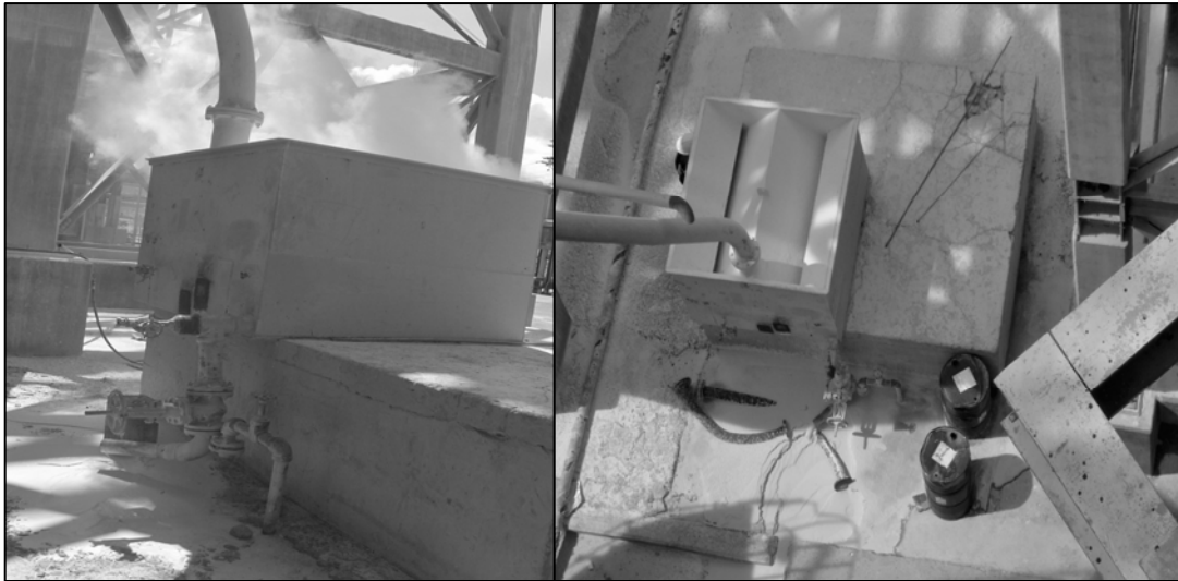
FIGURA 4.3. Recolector del sistema de succión de la tolva F-8 de FCC, imagen izquierda emisiones de catalizador durante la transferencia; imagen derecha vista superior del recolector.
