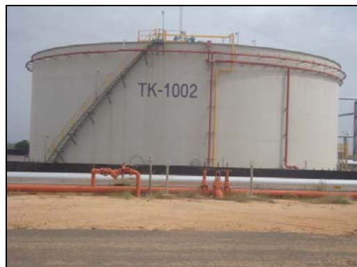
Figura 2.5 Tanque de alimentación de CDH
