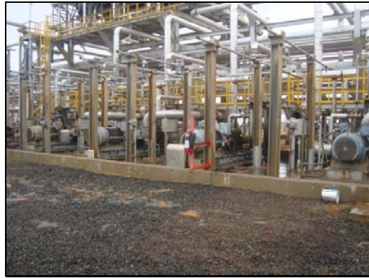
Figura 2.10 Bombas de transferencia de CDS
