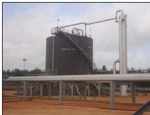
Figura 2.3 Tanque de compensación de CDH (izq.) y bota desgasificadora (dcha.)
