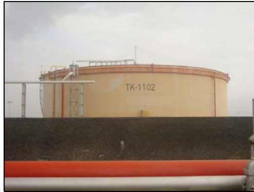
Figura 2.11 Tanque de almacenamiento de CDS
