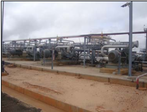
Figura 2.4 Bombas de transferencia de CDH
