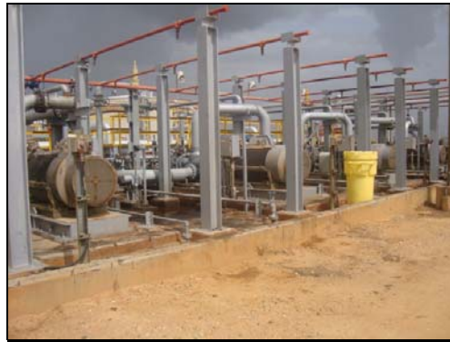
Figura 2.6 Bombas de alimentación de CDH
