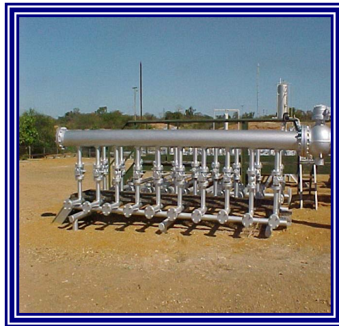
Figura 2.6 Múltiple de producción de 10 puestos instalado en la estación de flujo ZEF-8.
