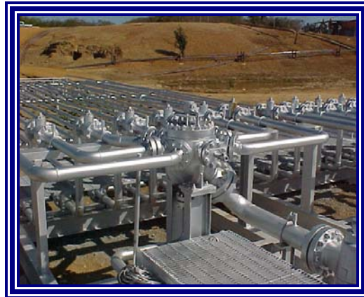
Figura 2.7 Válvulas multipuertos instaladas en estación de flujo X-8.
