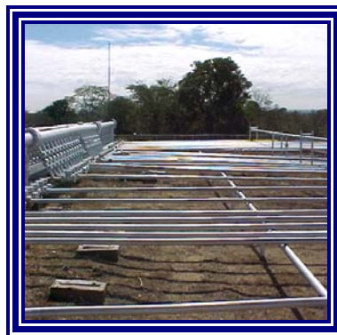
Figura 2.5 Tuberías para la conexión de los pozos con el múltiple de producción.
