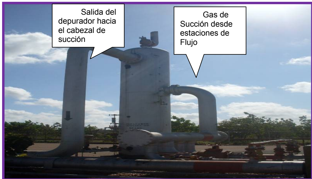
Figura 3.2. Depurador principal de la planta compresora.
