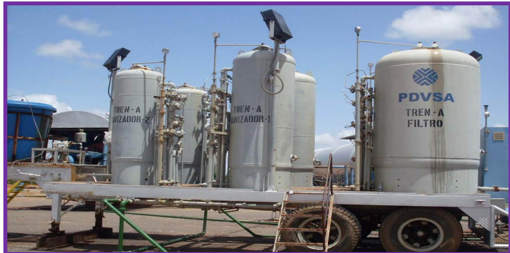
Figura 3.5. Planta de tratamiento de agua
