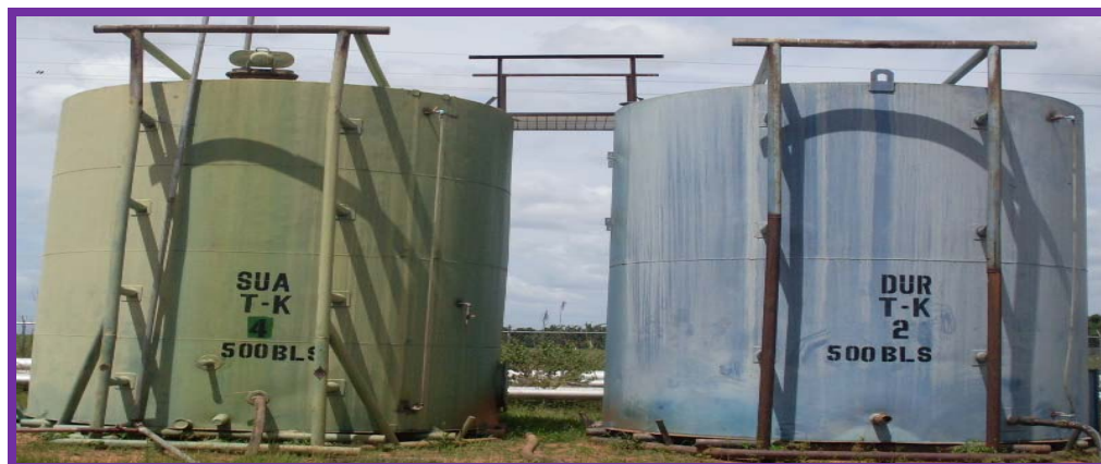
Figura 3.6. Tanques de agua almacenamiento de agua suave.
