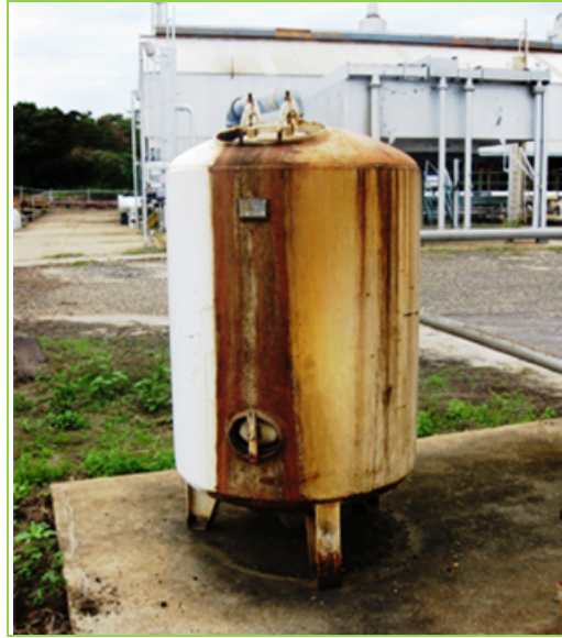
Figura 4. 6. Filtro de arena de la planta compresora
