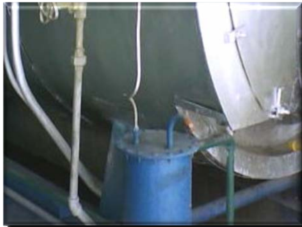
Figura 3.3 Toma de muestra del agua interna de la caldera [Fuente propia].
