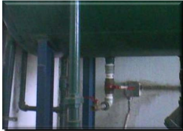
Figura 3.2 Toma de muestra del tanque de agua de alimentación [Fuente propia].
