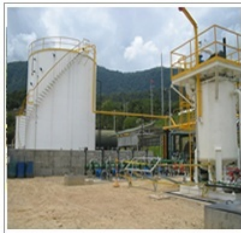
Figura 2.3. Vista externa de tanques desnatadores [21].
