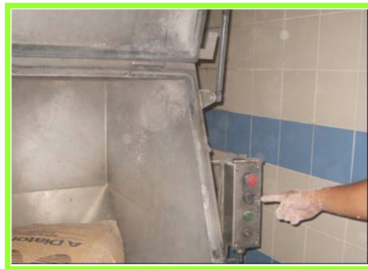
Figura 3.8. Selector de arranque en la esclusa de la estación de tierra/carbón.
