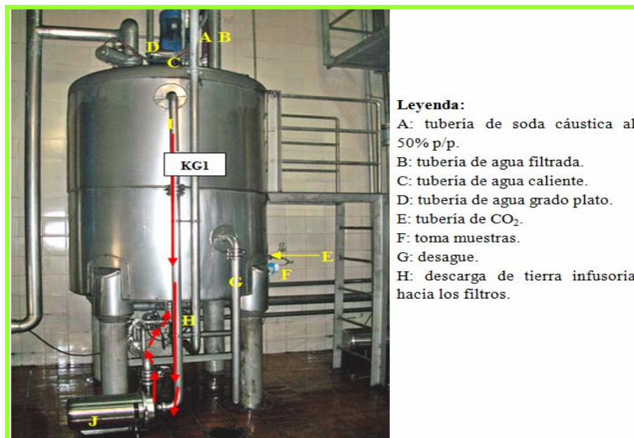
Figura 3.17. Tanque KG1 (tanque piloto).
