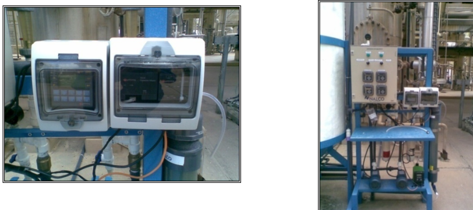
Figura 3.20 Instalación del PLC en la planta piloto
