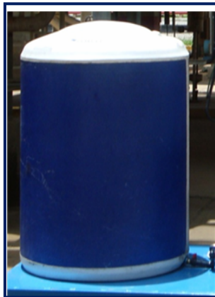
Figura 3.7 Tanque de almacenamiento del agua clarificada
