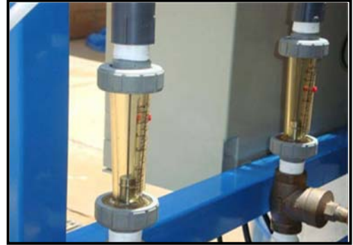
Figura 3.11 Rotámetros de bombas.
