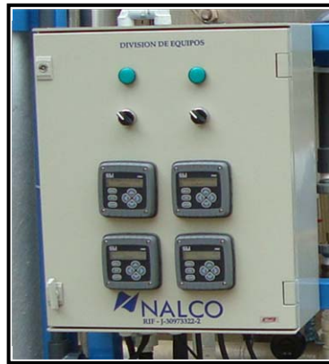
Figura 3.13 Panel de control de bombas con 3 medidores de ORP y una de pH.
