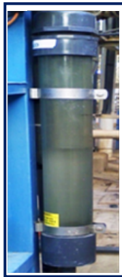
Figura 3.6 Tanque de almacenamiento del producto químico.
