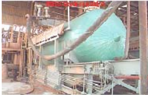
Figura 1.8 Filtro Kelly usado en el área de filtración de seguridad
