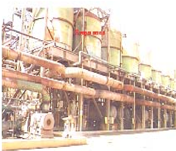
Figura 1.9 Tren de tanques expansores que conforman el área de enfriamiento por expansión instantánea.
