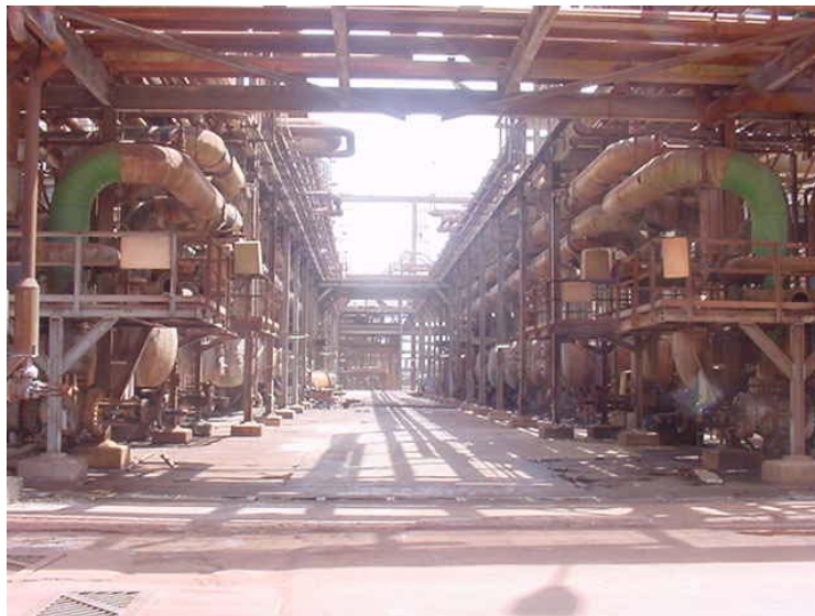
Figura 1.11 Intercambiadores de calor.
