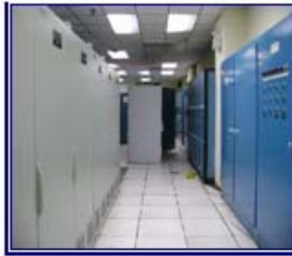
Figura 3.2 Gabinetes en Sala de Control
