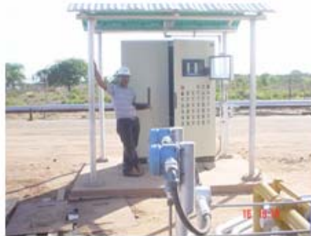
Figura N° 4.6: Vista Externa Panel de Encendido del Horno H1 basado en PLC.
