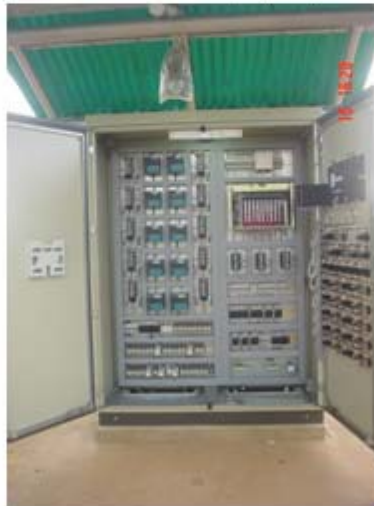
Figura N° 4.7: Vista Interna Panel de Encendido del Horno H1 basado en PLC.
