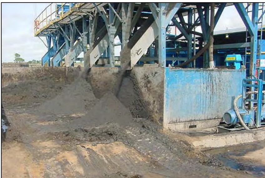
Foto 4. Fracción líquida obtenida de la separación del lodo en la unidad de Dewatering
