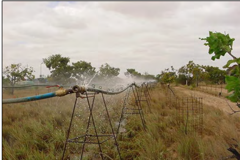
Foto 11. Asperjado de áreas verdes con aguas tratadas y en cumplimiento con el Decreto N° 883
